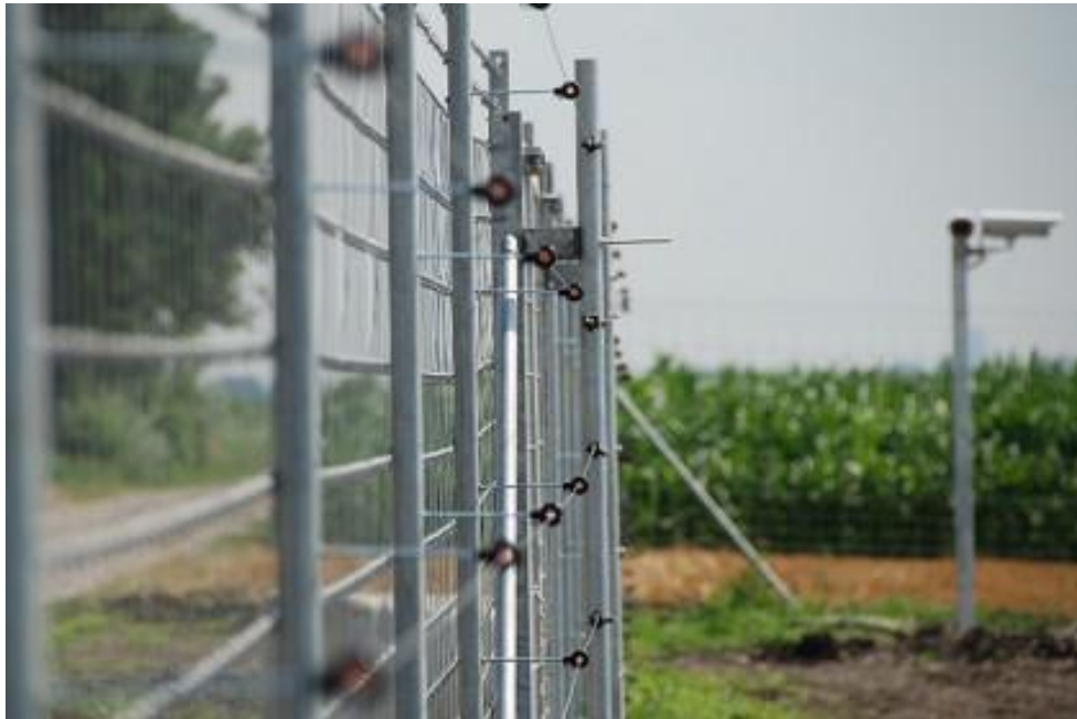
Rysunek 4 Przykładowe ogrodzenie farmy fotowoltaicznej
