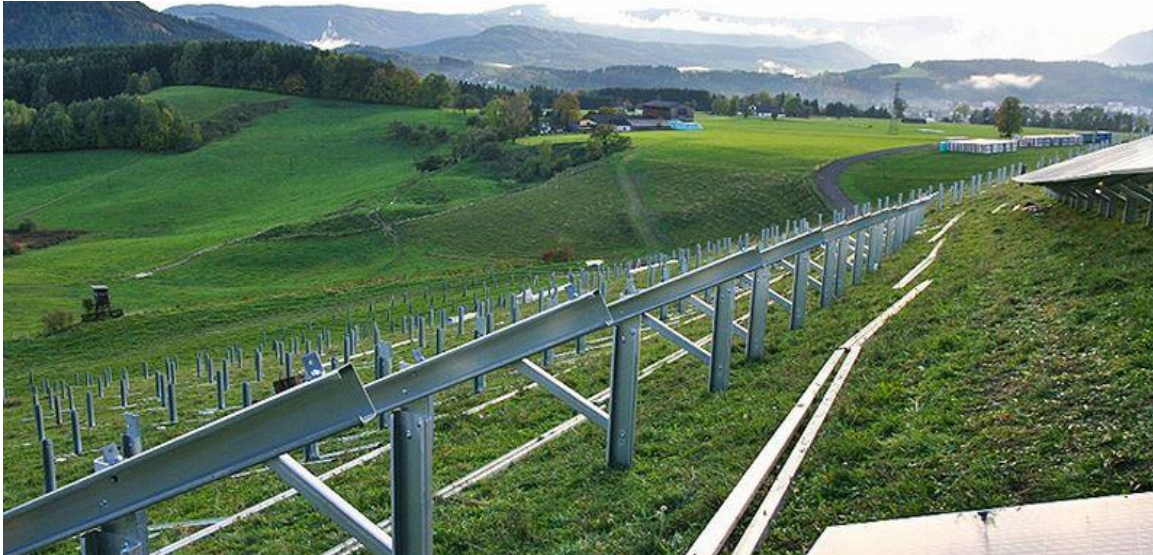
Zdjęcie 6 Konstrukcja przeznaczona do posadowienia paneli fotowoltaicznych.
